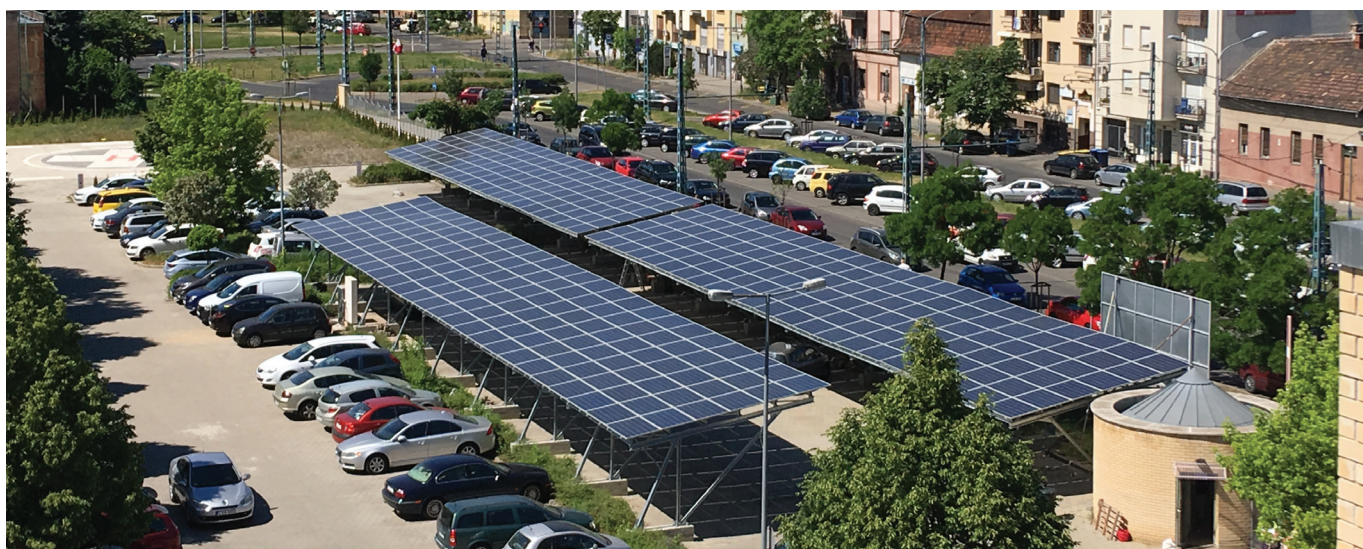
Budapest, Uzsoki utca - 424 kWp; Carport - 245,16 kWp
