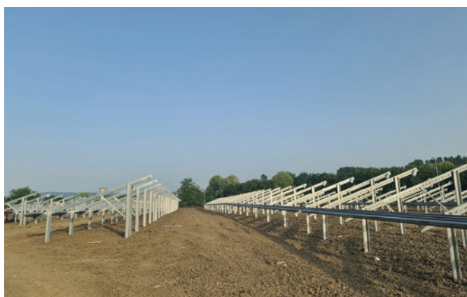
Aiud (Nagyenyed) 1 MWp
