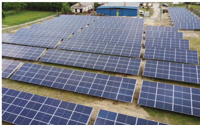
Óhíd (saját erőmű) 500 kWp
