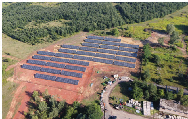
Nyirád (Own power plant) 1 MWp
